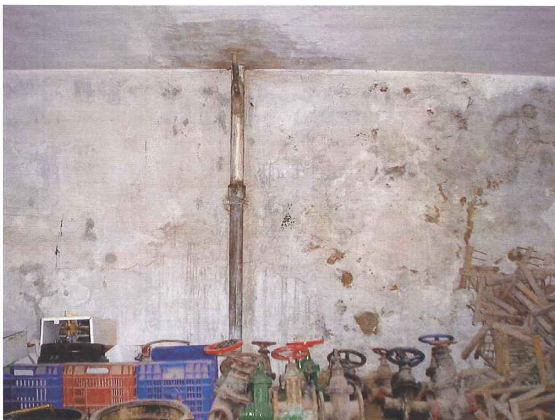
Humedad y estado de saneamiento en almacenes de la lonja
