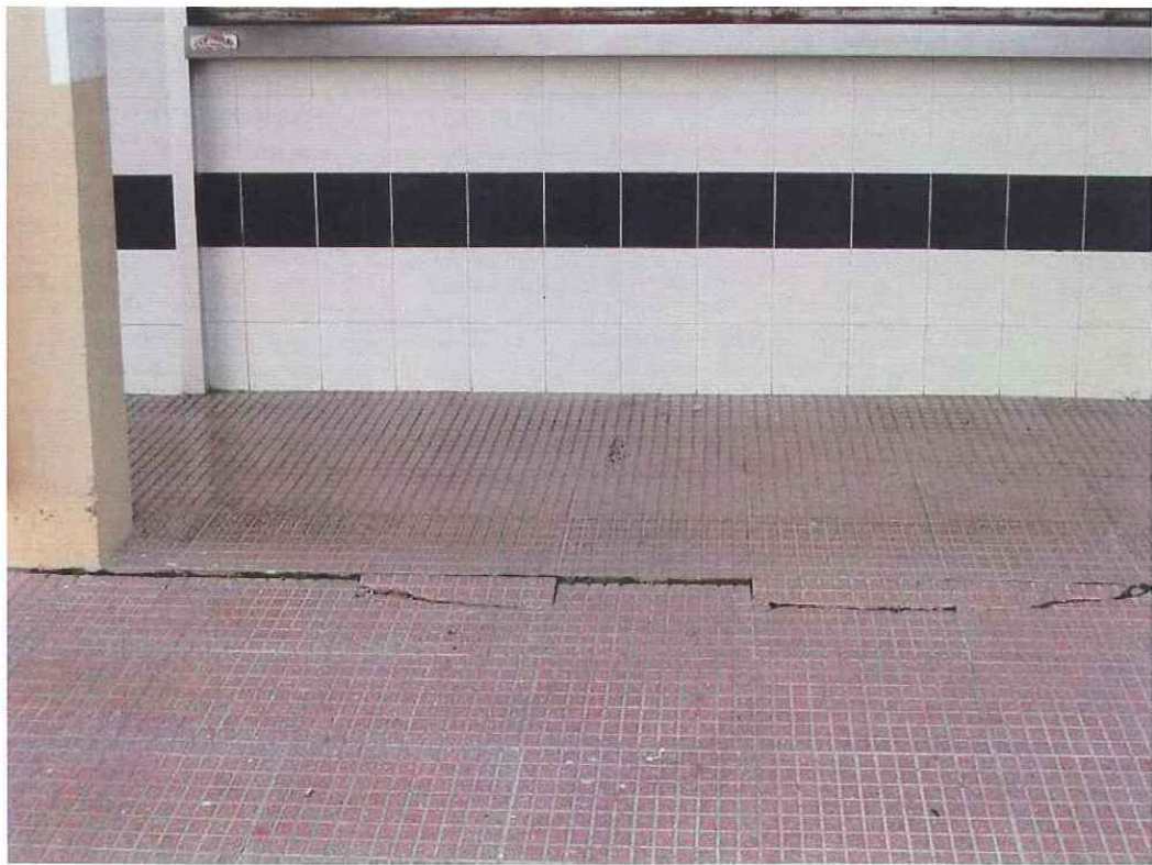
Detalle del hundimiento del patio
